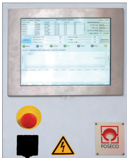
Abbildung 3: Touchscreen im Schaltschrank eines FDU Gerätes
